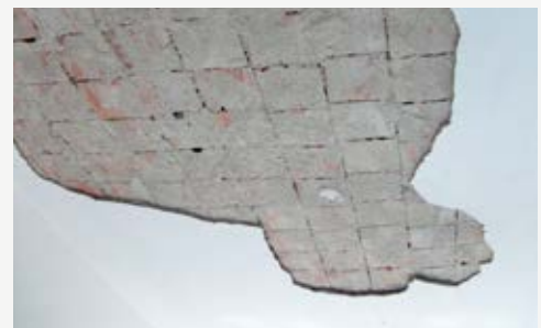
Distacco intonaco aula scolastica Rischio fino a 1000 Kg
