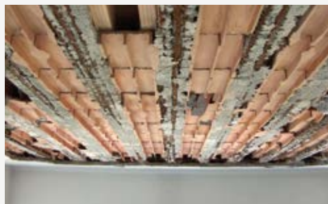
Sfondellamento aula scolastica Rischio fino a 1500 Kg
